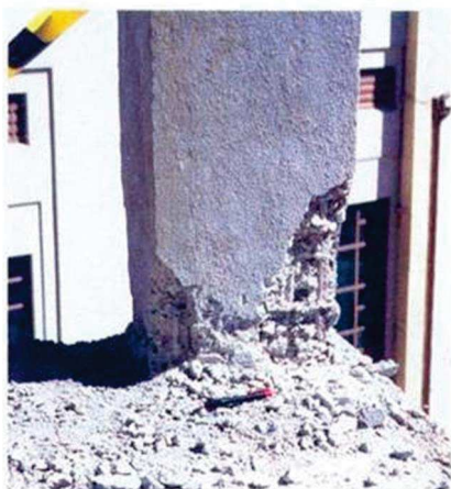
Vazio de concretagem
