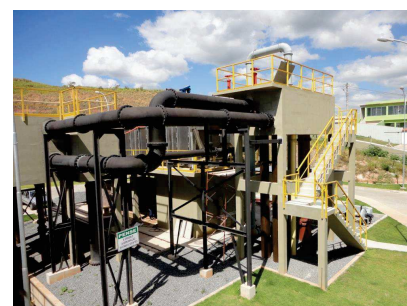
ETE OLARIA - GUARAPARI VISTA TRATAMENTO PRELIMINAR
