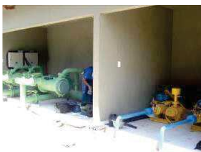
ETE ULISSES GUIMARÃES SOPRADORES E ULTRAVIOLETA
