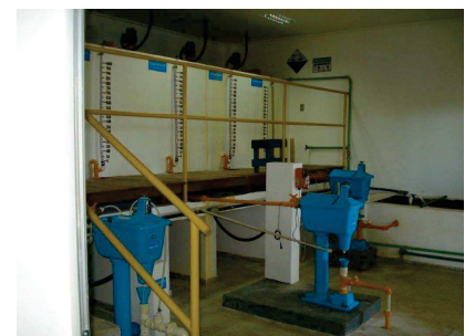
ETA VIANA SALA DE DOSAGEM
