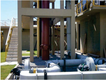
ETE OLARIA - GUARAPARI CLARIFICADO / DESCARGA / GÁS
