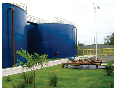
ETE ULISSES GUIMARÃES TRATAMENTO PRELIMINAR E EEEB
