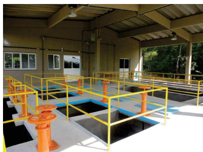
ETA VIANA FLOCULADOR, DECANTADORES E FILTROS
