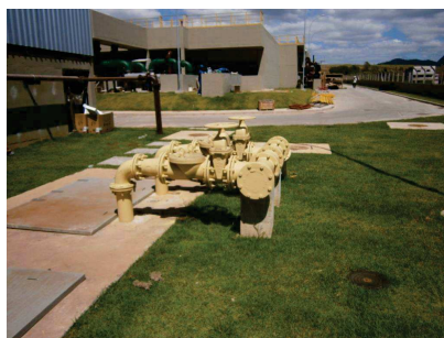
ETE OLARIA - GUARAPARI EEEB DE CLARIFICADO
