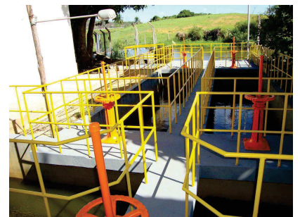
CAPTAÇÃO JABOTI - GUARAPARI CANAL E POÇO DE SUÇÃO
