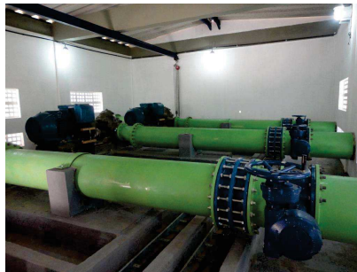
BOOSTER RIO GRANDE - GUARAPARI BARRILETE – ÁREA INTERNA
