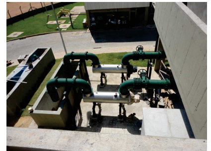
ETE OLARIA - GUARAPARI EFFLUENTE TRATADO - UV
