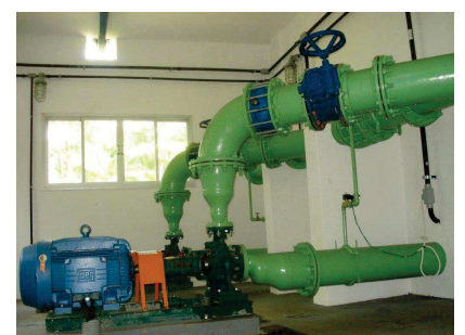
CAPTAÇÃO VIANA BARRILETE
