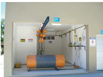
ETA VIANA CLOROGÁS
