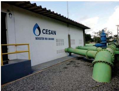
BOOSTER RIO GRANDE - GUARAPARI BARRILETE – ÁREA EXTERNA
