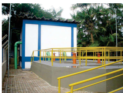
CAPTAÇÃO VIANA CANAL E POÇO DE SUÇÃO
