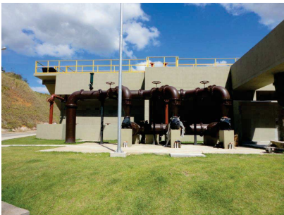
ETE OLARIA - GUARAPARI RETORNO DE LODO DECANTADO
