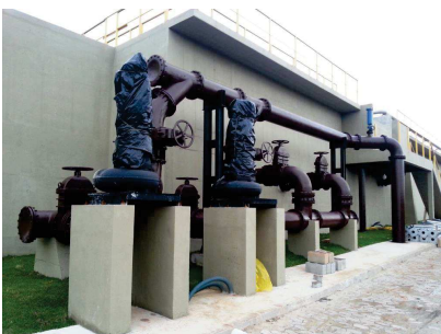
ETE OLARIA - GUARAPARI ELEVATÓRIA DE RECIRCULAÇÃO
