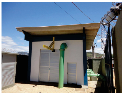
BOOSTER PEROCÃO - GUARAPARI VISTA INTERNA DA ÁREA
