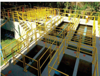
ETA IBATIBA FLOCULADOR, DECANTADORES E FILTROS
