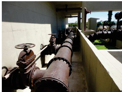
ETE OLARIA - GUARAPARI RETORNO DE LODO DECANTADO
